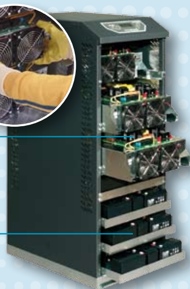
Удаляемые внутренние батареи (10-20kVA)
