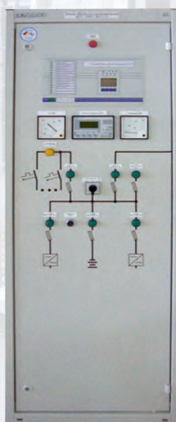
Панель ЩПТ с регистратором аварийных событий
